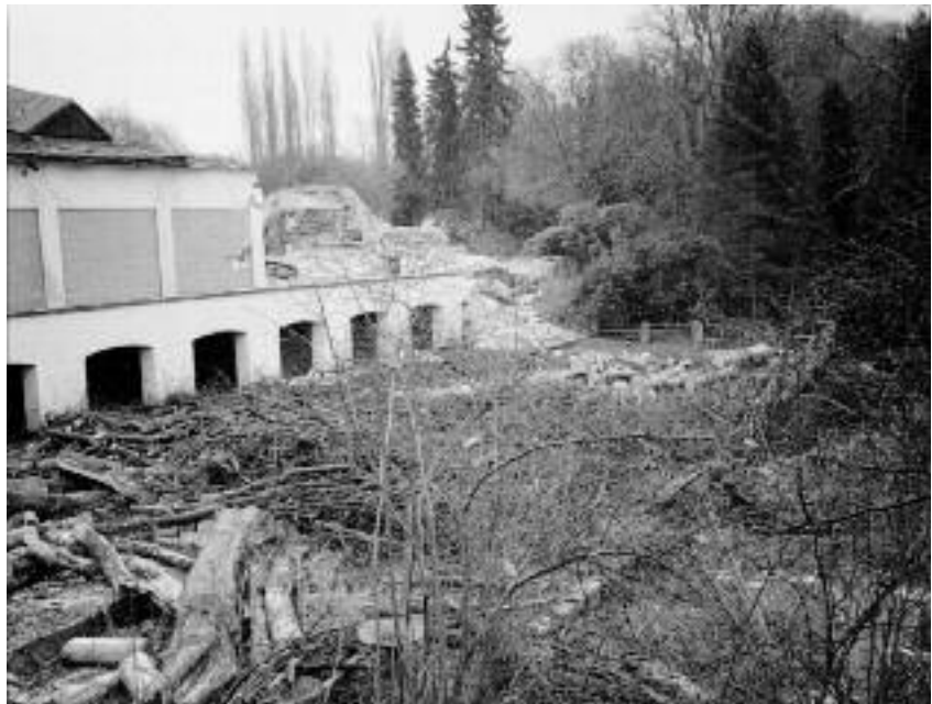
Abbruch des alten Restaurants und späteren „Remix“-Tanzsaales im Dezember 2002. In der Mitte die ehemalige Caféterrasse, rechts der frühere Gartenteich. Beide sollen wiederhergestellt werden
