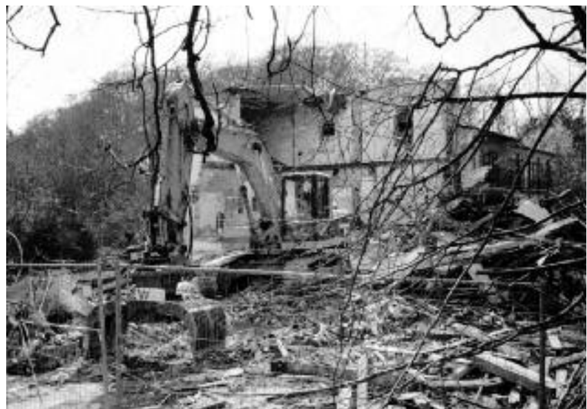
Abbruch des alten Brauereigebäudes zwischen dem ausgebrannten Fachwerkhaus und dem alten Hotel (ganz rechts) im März 2004
